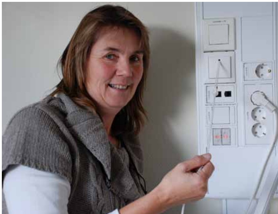
Smarthusteknologien ble installert under oppføring av bygningene. Det er Sigrid Gusland fornøyd med.
