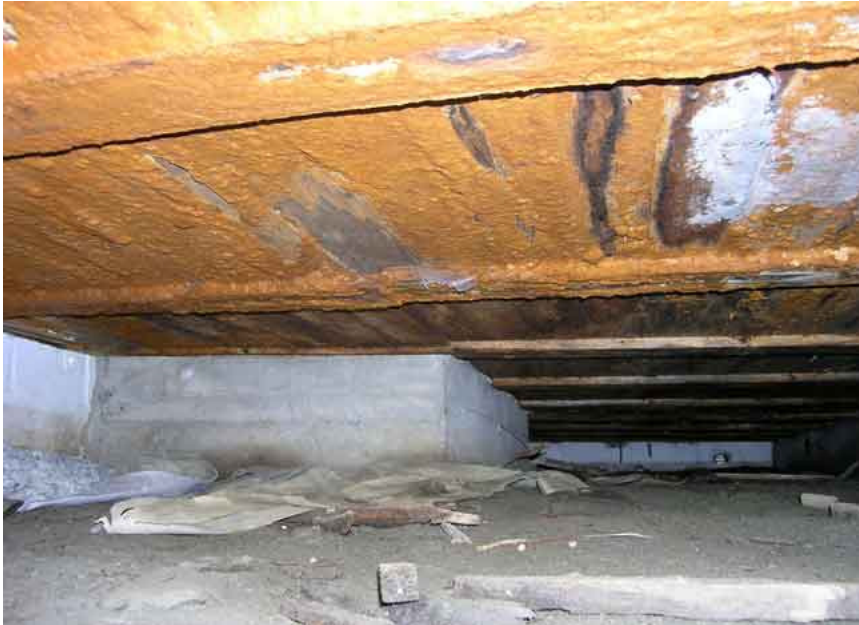
Figur 5.2 Råteskader i bjelkelag og stubbeloftsbord. Foto: SINTEF Byggforsk
