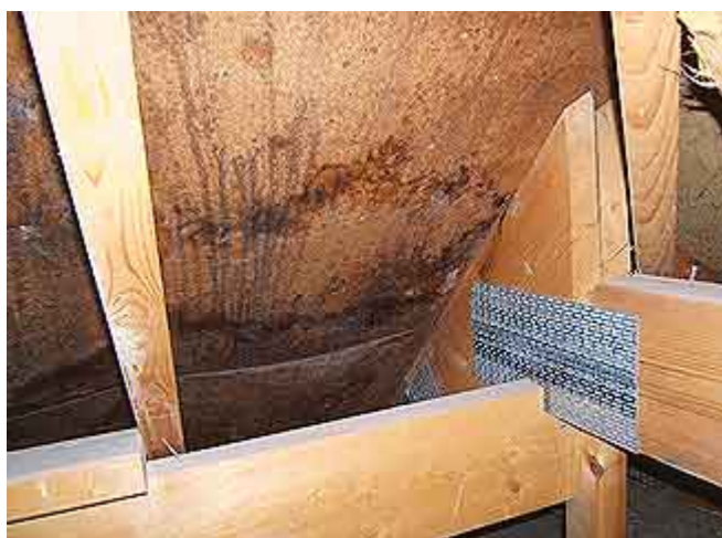
Figur 4.2 Det kan oppstå soppangrep på undertak som er fuktig over lange perioder. Det gjelder først og fremst dampete undertak som vist på bildet. Foto: SINTEF Byggforsk
