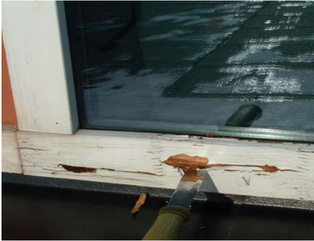
Figur 7.3 b Vinduet har ikke tilstrekkelig klem på pakningen mellom glasset og treverket slik at vann har trengt ned og blitt stående mellom glasset og treverket. Over tid har det utviklet seg en råteskade.
