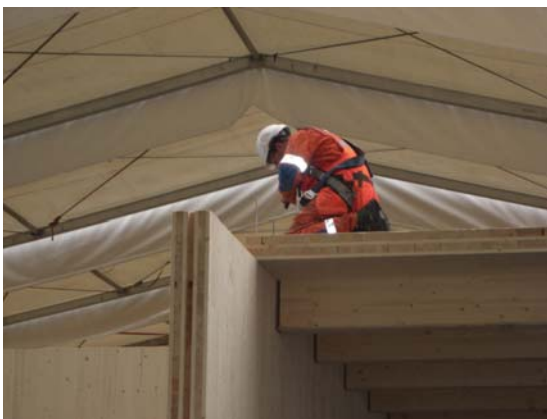
Fig. 1.4 Værbeskyttet bygging gir god beskyttelse av konstruksjon og også gode arbeidsforhold for håndverkerne. Foto: SINTEF Byggforsk
