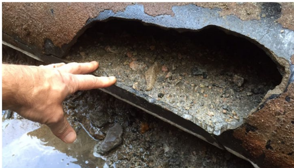
MANDAL: Gamle vannrør i støpejern fra 1867. FOTO: KAI STOKKELAND / NRK
