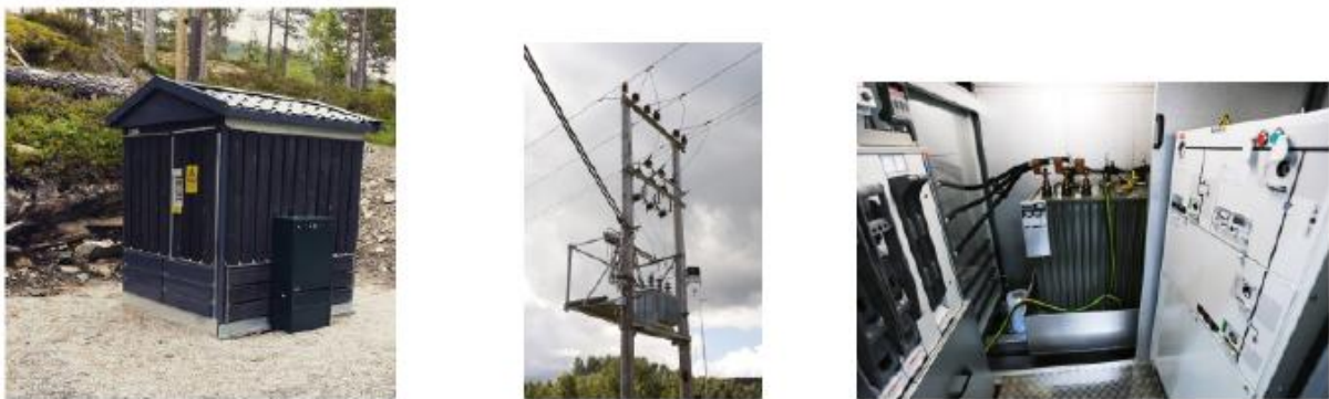
Figur 1 Ulike typer nettstasjonsinstallasjoner som inngår i piloten: Kiosk, mast og bygg.
