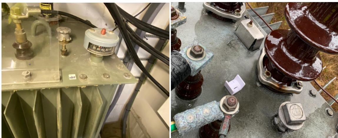
Figur 2 Eksempel på temperatursensor på toppen av nettstasjonstransformator. Trafo i kiosk til venstre, mastemontert trafo til høyre.
