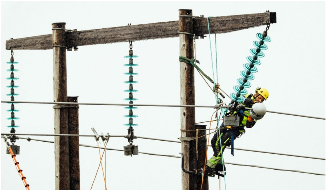
Figur 4: Bilde fra installasjon hos Arva. Gjort på utkoblet linje.
