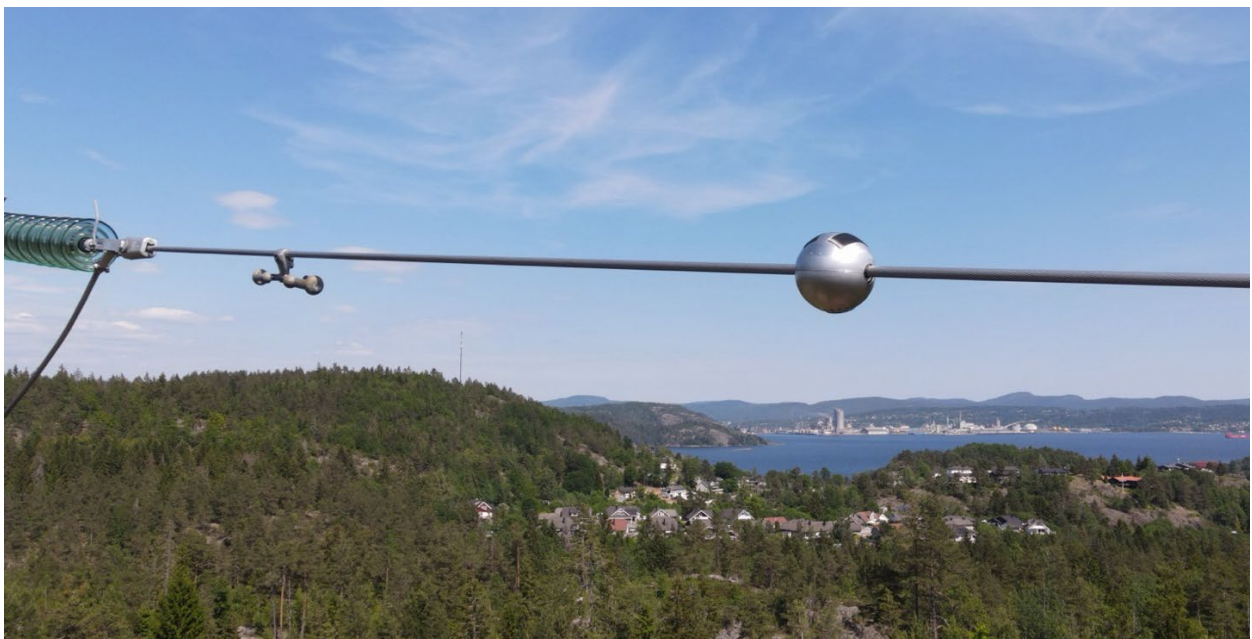
Figur 1: Heimdall Neuron på en av linjene i prosjektet. Installert med drone.
