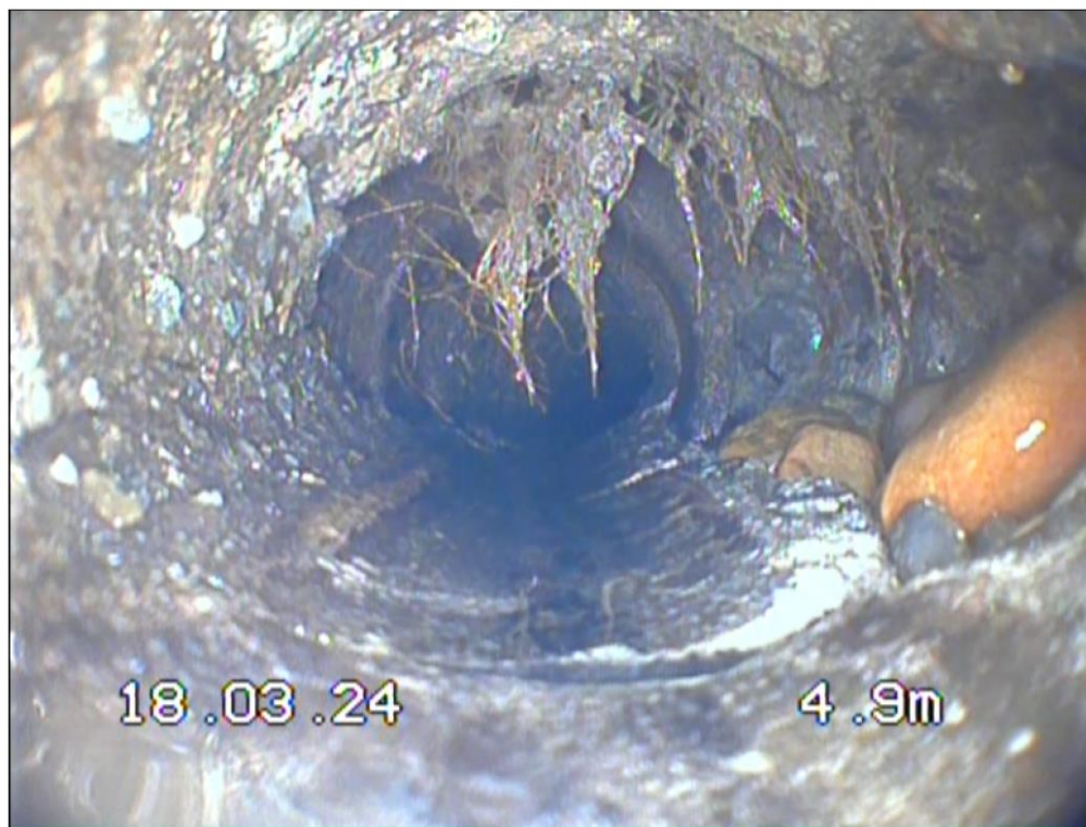
Foto: 2_1_12_02042024_105023_B.jpg 4,9m, Sprukket rør, Rørbiter har løsnet eller mangler/teglstein mangler fra sin opprinnlige posisjon, fra 01 til 05 Kl., Tangentiell, Start
